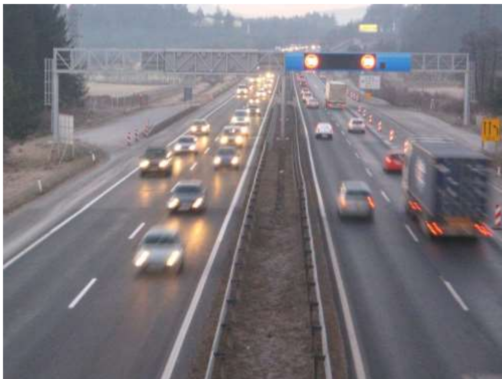
Slika 11.6.7: PSIS portal iznad kolovoza na zapadnoj ljubljanskoj obilaznici
