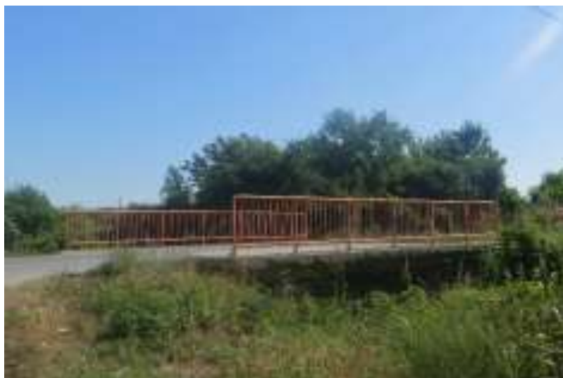
Слика 8. Пропуст на км 190+400.00
