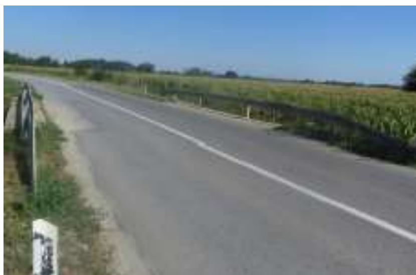
Слика 9. Пропуст на км 190+800.00
