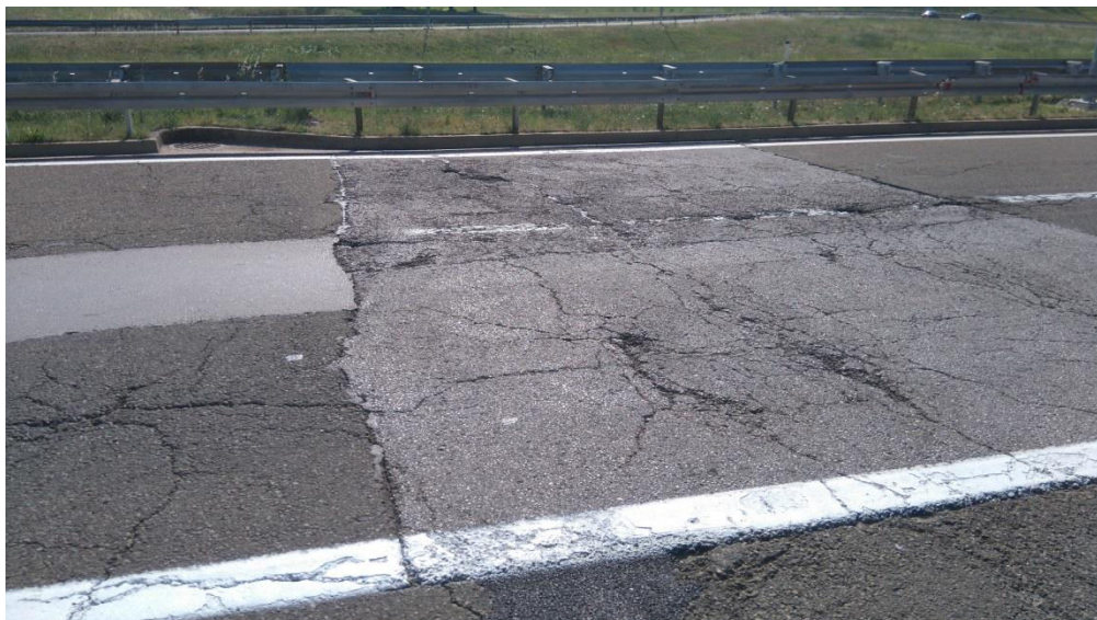
Слика 22. Пример оштећења на деоници
