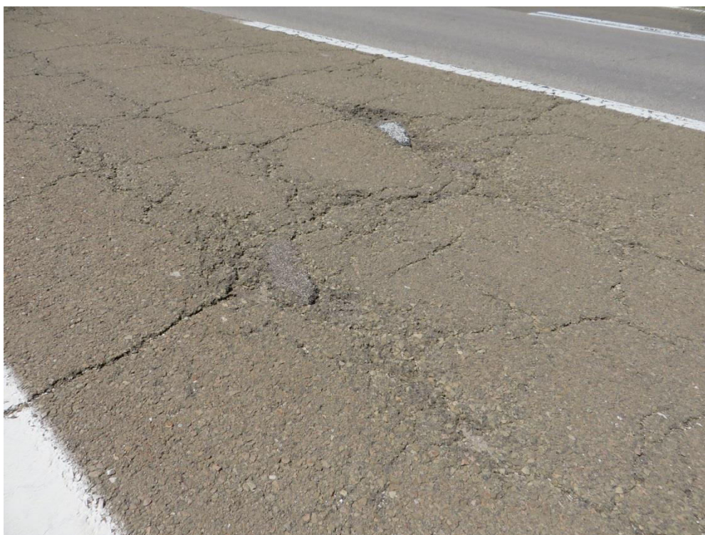
Слика 23. Пример оштећења на деоници
