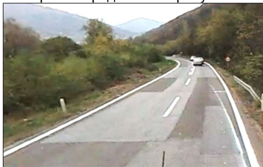
Слика 42: Оштећења коловоза
