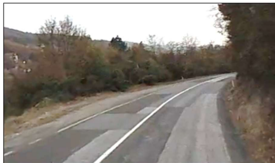
Слика 43: Оштећења коловоза
