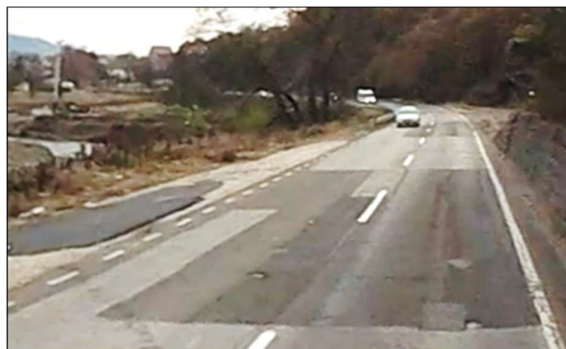
Слика 45: Оштећења коловоза
