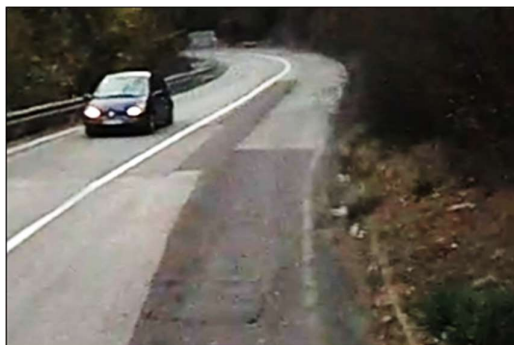
Слика 44: Оштећења коловоза
