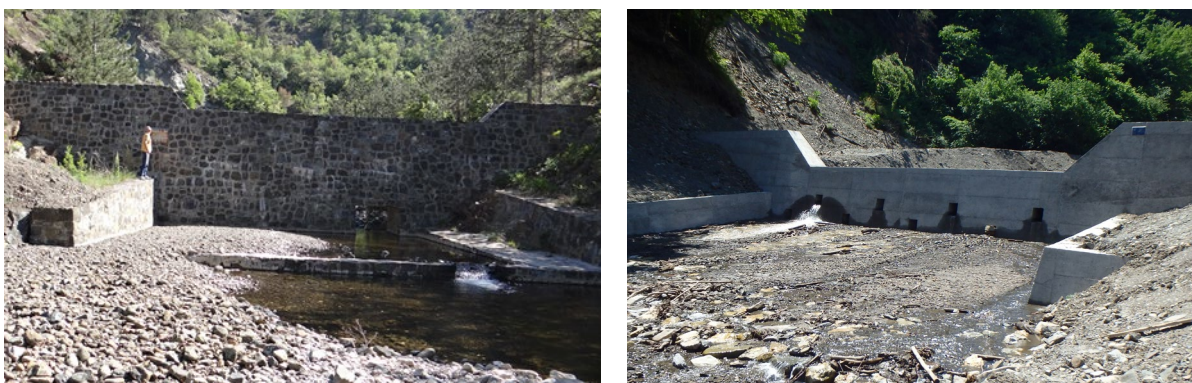
Слика 24 - Бујичне преграде од камена у цементном малтеру и од бетона
