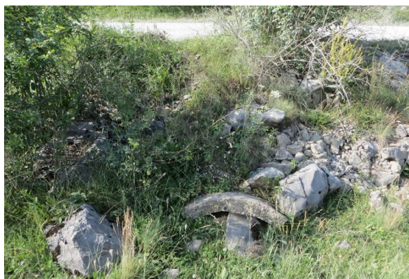
Слика 36 - Предлог 6 – локација 378 на путу IIA реда (ознака пута 202, Сјеница (Карајукића Бунари) - Карајукића Бунари (Сјеница)). Оштећен и урушен пропуст.
