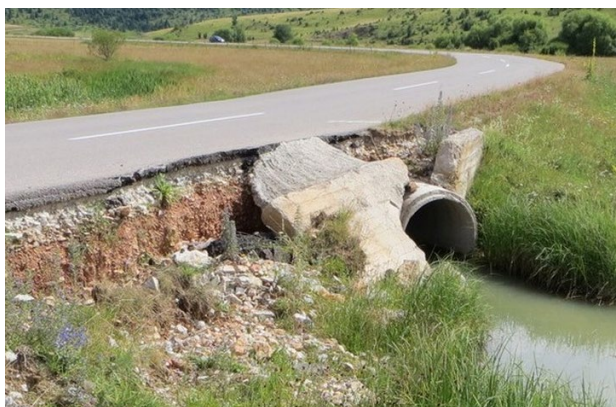
Слика 35 - Предлог 5 – локација 392 на путу IIA реда (ознака пута 202, Карајукића Бунари (Тутин) – Тутин (Веље Поље)). Оштећене бочне стране пропуста.
