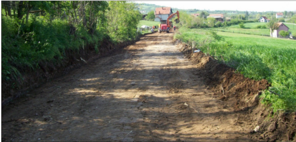
Fotografija 7. Izgradnja lokalnog puta u selu Stepanje, opština Lajkovac (Foto V. Popadić)
