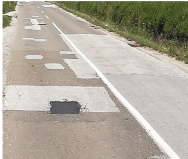
Fotografija 11. Detalj oštećenja kolovozne konstrukcije lokalnog puta (Foto: V. Popadić)
